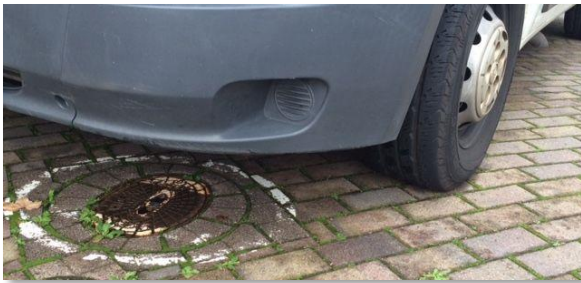
Bild 1: Auto über Unterflurhydrant
