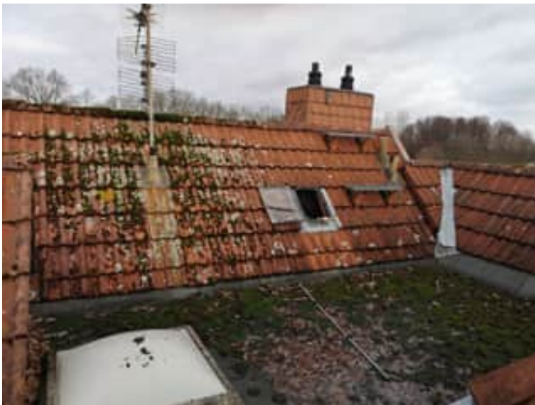
oberes Flachdach, stehendes Wasser/Grünbewuchs
