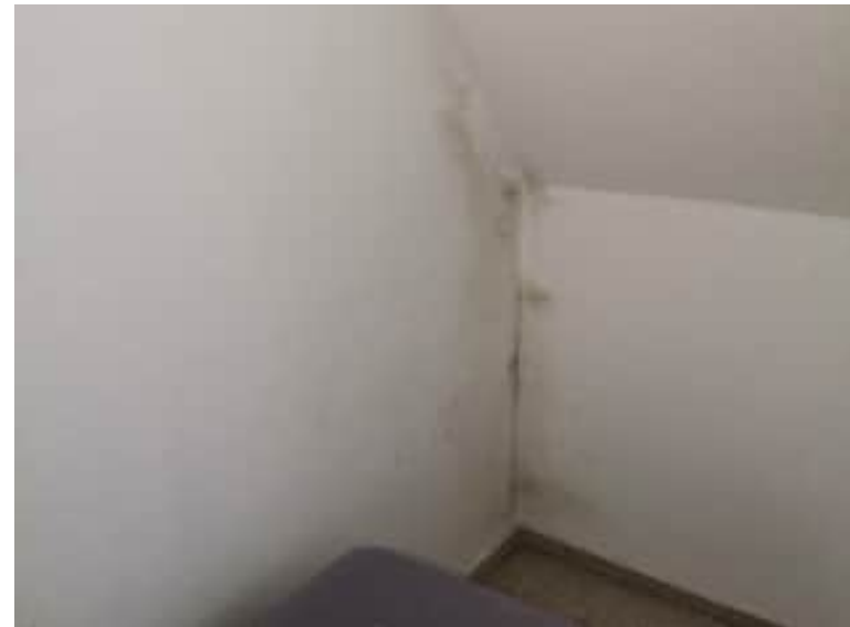
Feuchteerscheinungen (Kondensat wg. geringer Dämmung)
