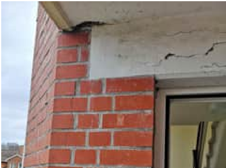
Fenstersturz, Rissbildung aufgrund von Setzungen
