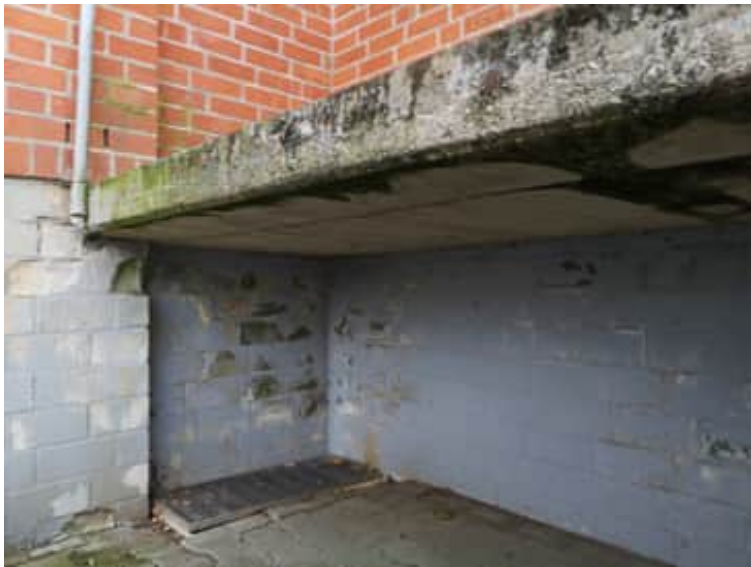
Gebäuderückseite, Korrosionen/Begrünungen Rampe
