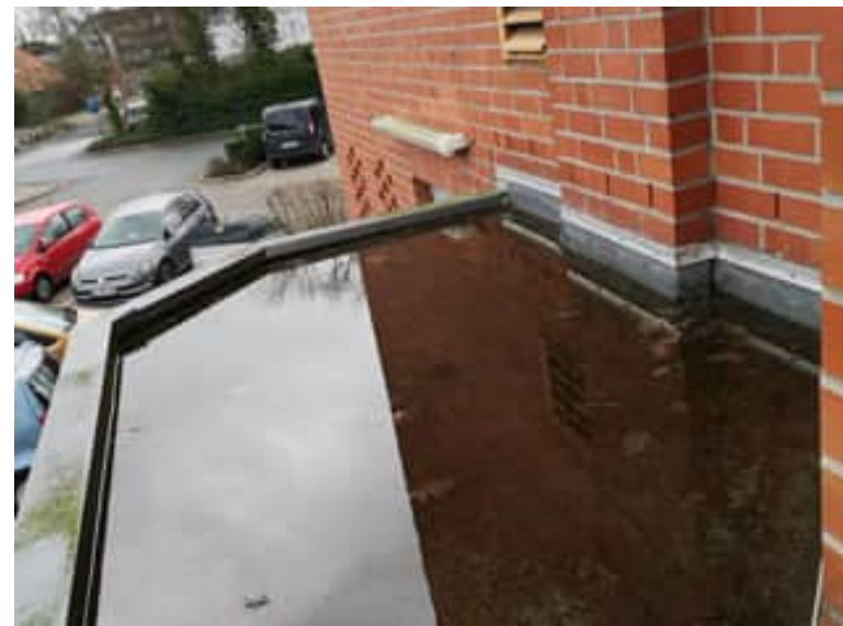
Gebäuderückseite, stehendes Wasser Vordach
