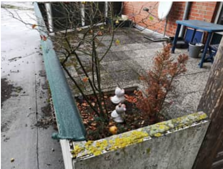
Terrasse OG 1, alter Belag, Abdichtung nicht erneuert
