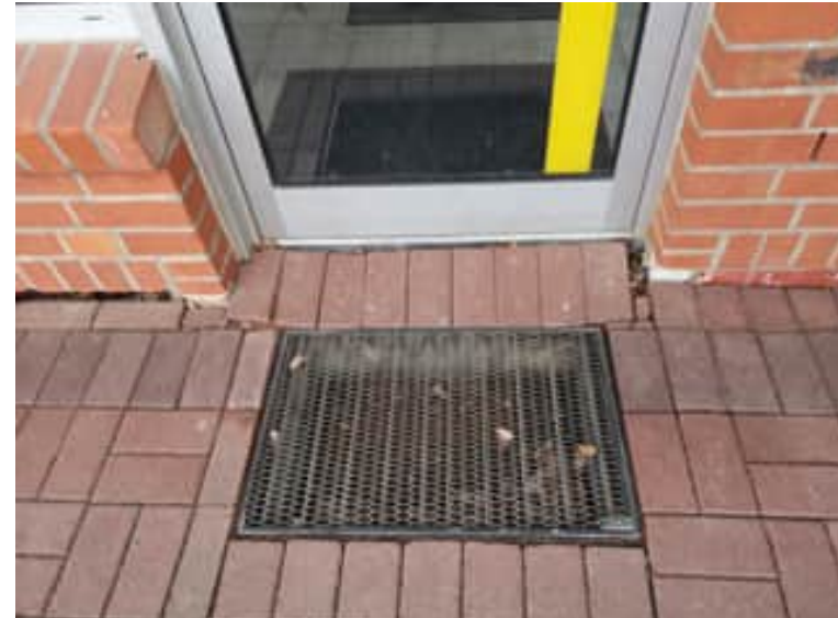
Außenanlagen, Absackungen des Pflasters, Gegengefälle
