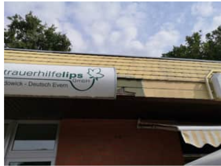
beschädigter Dachkranz EG, belastete Schindeln, Altanstrich
